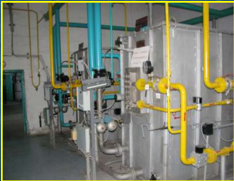
В котельной д.Соколовка
