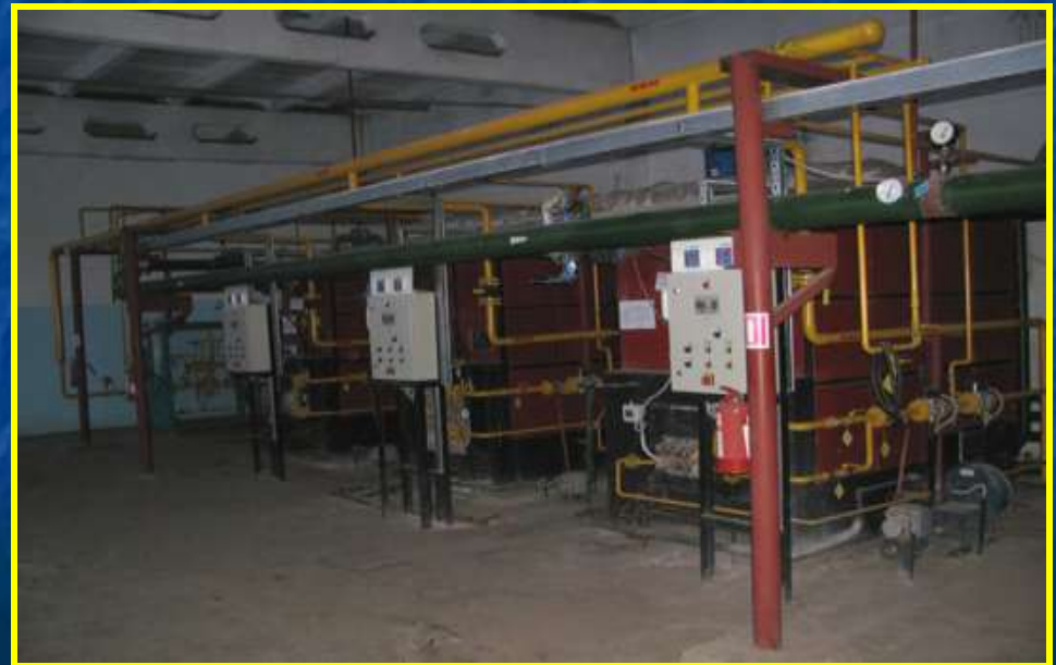
В котельной с.Мостовое
